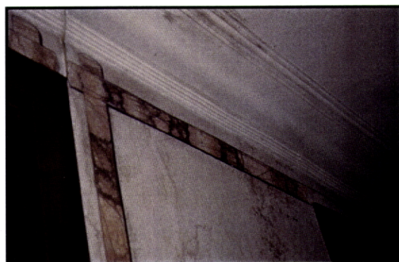
Fig. 193 – Casa Nicanor. Meadela. Parede em stucco-lustro atacada por intensa colonização biológica.
