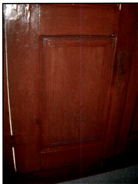
Fig. 276 – Casa do Pinheiro. Guimarães. Um verniz mal aplicado tornou impossível a identificação da madeira fingida.
