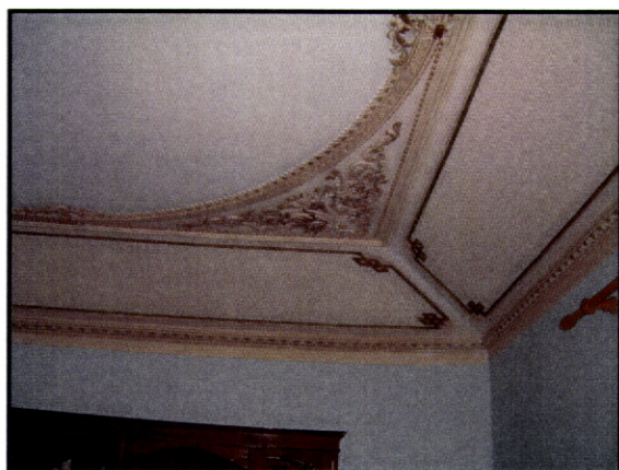
Fig. 340 – Casa do Caçador. Afife. Tecto em masseira decorado em tons de marfim e pintado a ouro.
