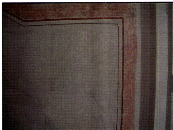
Fig. 205 – Casa do Alves. Afife. Os paramentos evidenciam necessidade de intervenção.
