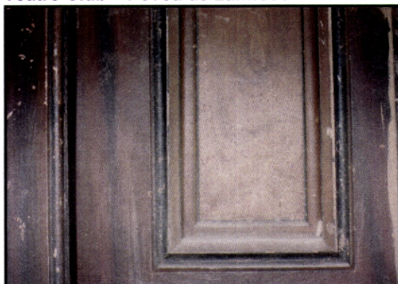
Fig. 286 – Teatro Club. Póvoa de Lanhoso. Fingido de castanho deteriorado. Aspecto da porta antes do restauro.
