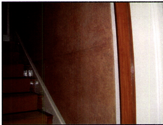
Fig. 196 – Casa Painhas. Viana do Castelo. Marmoreado fingido no vão da escada de acesso ao piso superior.
