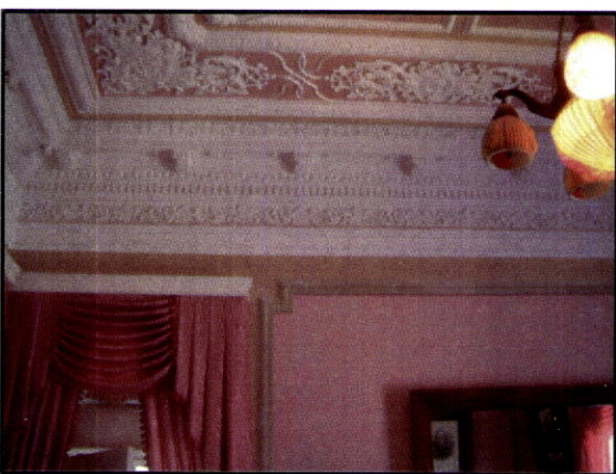
Fig. 403 – Casa Painhas. Viana do Castelo. Vista geral do compartimento. A parede está pintada num interessante fingido de tecido adamascado.
