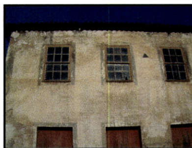
Celorico de Basto. Imóvel do Séc. XIX com barramentos a cal. (Foto da autora).
