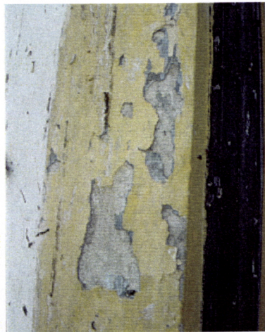
Fig. 4.20. Pormenor de vão com camadas de pintura sobrepostas a guarnecimento de simulação de pedra
