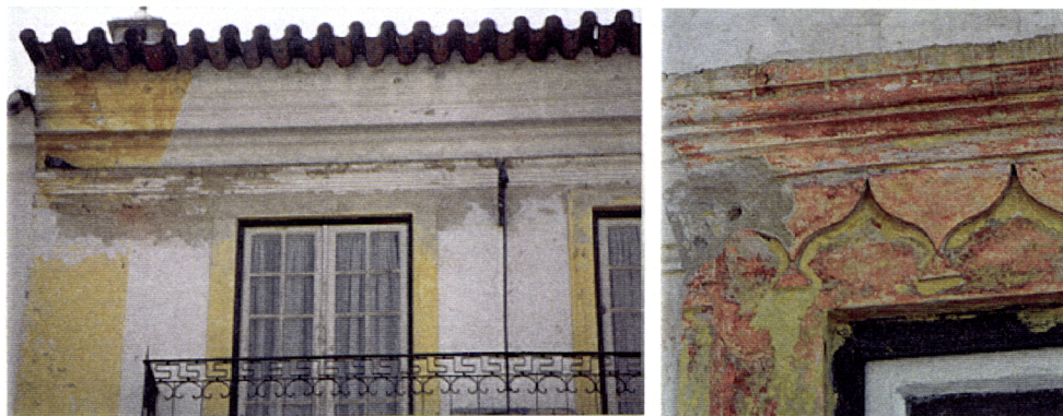
Fig. 4.37 e Fig. 4.38. Lacunas dos revestimentos e acabamentos das superfícies
