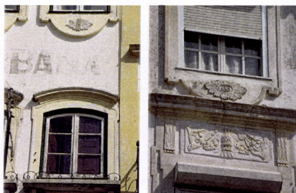
Fig. 4.39 e Fig. 4.40. Vãos que apresentam descamação superficial e descoloração
