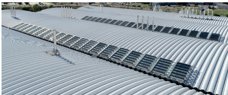
Fig. 6. Vista do campo solar instalado na cobertura.
