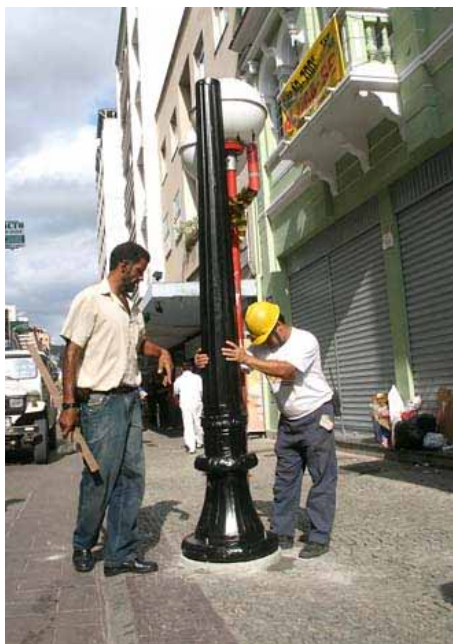
Figura 3 - Troca dos postes de iluminação da rua São João em 2008. Fonte: acessa.com
