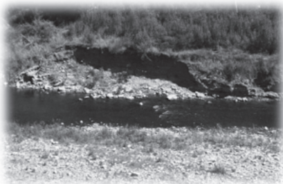
Erosão nos taludes
