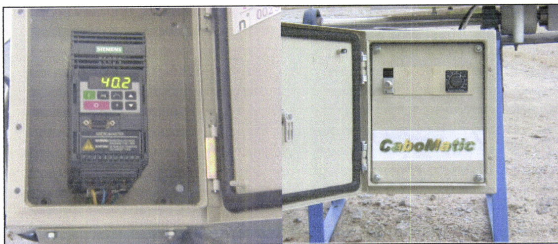
Figura 5.9 Esquerda: Sistema CaboMatic a 220V. Direita: Sistema CaboMatic solar.
